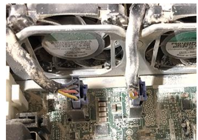
Baustaub in Lüftern
